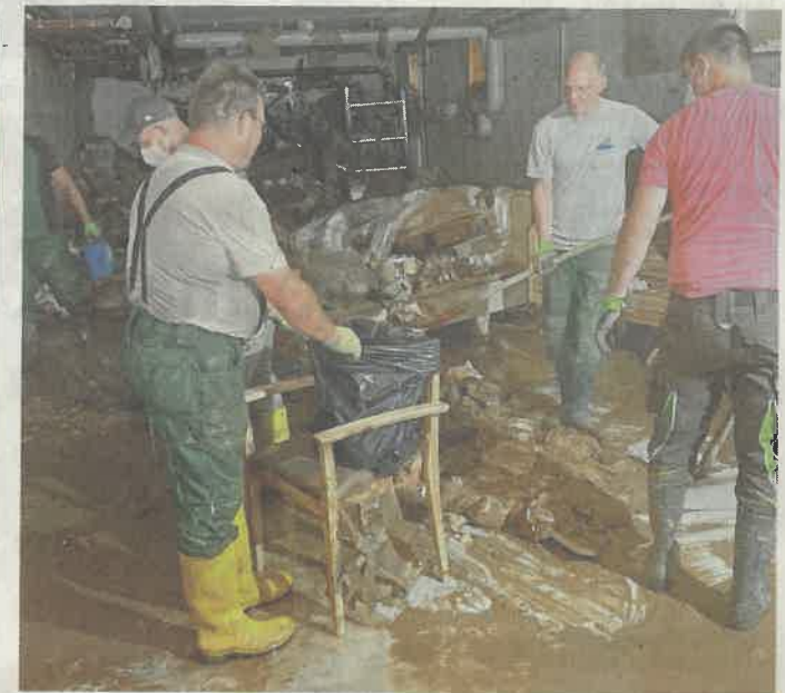
Tonnenweise Schlamm schaufelten die Männer aus dem Keller des Seniorenheims.
